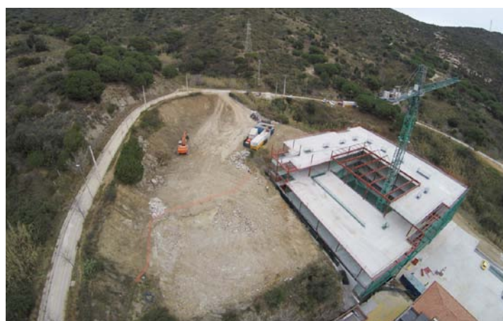
Imatge aèria de la construcció del nou Campus ICO-Germans Trias i Pujol de l'Institut (març 2015).
